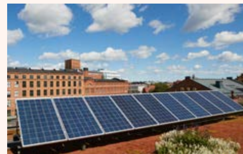
Corem har 29 solcellanläggningar, som här på taket på fastigheten Kopparhammaren 2 i Norrköping.
