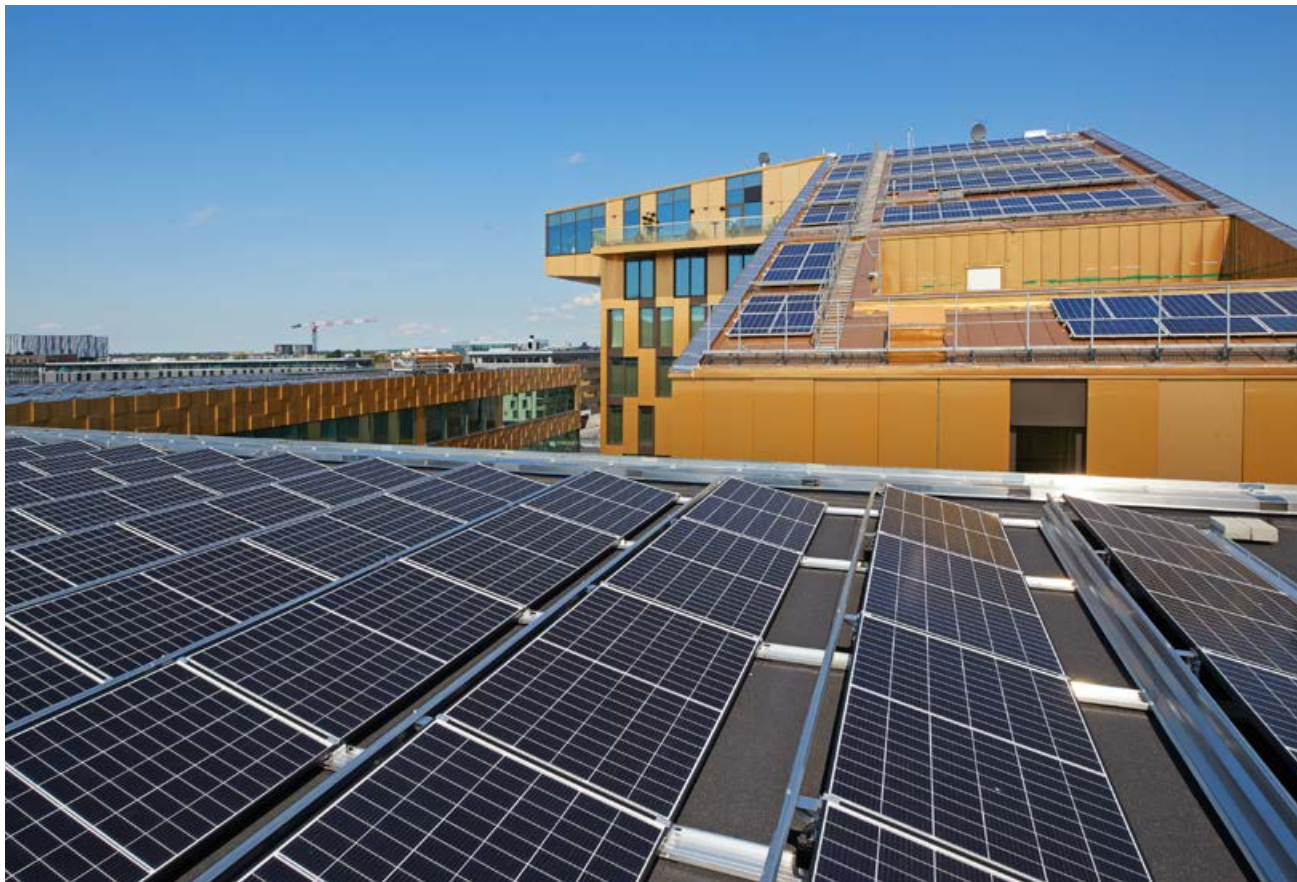
Solpaneler på taket på Uppsala Gate, Kungsängen 10:1 och 10:2.
